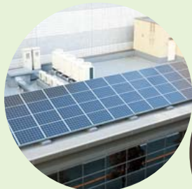
屋上の太陽光パネル
